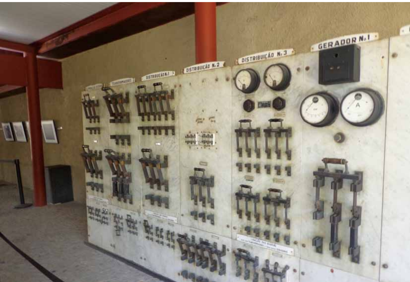
Painel do gerador restaurado.
